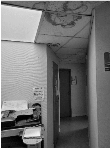
Traces visibles de dégât des eaux
