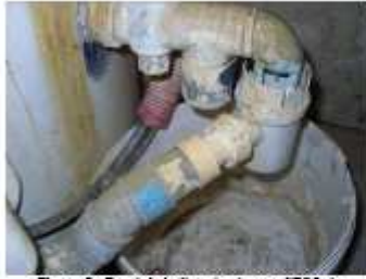
Figure 6 : Fond de baignon du réseau d'ECS de l'Orangerie en mauvais état pouvant impacter la maintenance et l'entretien
