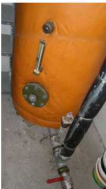
Figure 2 : Thermomètre du ballon de cloilage du réseau d'EC3 du Château principal. Les températures des réseaux d'EC3 de l'établissement ne sont pas relevées ni consignées manuellement dans un carnet sanitaire
