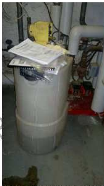
Figure 3 : Adoucisseur présent sur le réseau d'EC3 du Château principal. Celui-ci ne possède pas de bae de rétention
