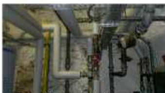
Figure 1 : Absence de signalétique sur les canalisations et absence de coloriage des locaux de production et des réseaux d'eau
