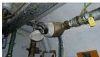
Figure 4 : Disjoncteur du réseau d'EC3 du Château principal. Les autres réseaux de l'établissement ne sont pas équipés par ce type de dispositif
