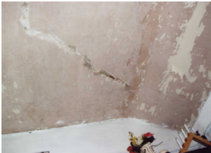
Fissure au plafond de la chambre des enfants
