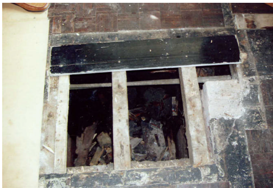
Résultat de la chute d'un locataire à travers le parquet pourrie de la cuisine
