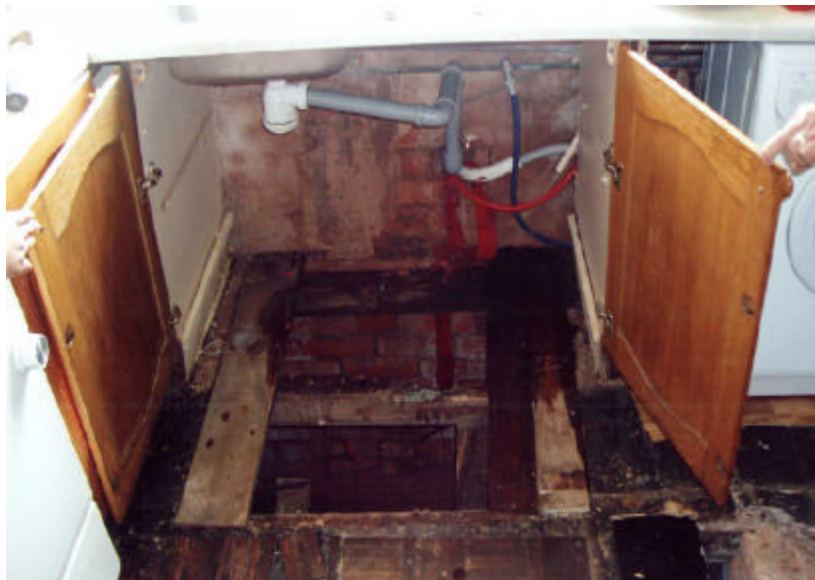
Absence de parquet sous l'évier de la cuisine
