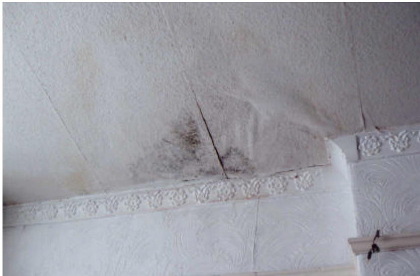
Moisissure suite à l'infiltration d'eau au plafond de la chambre des enfants
