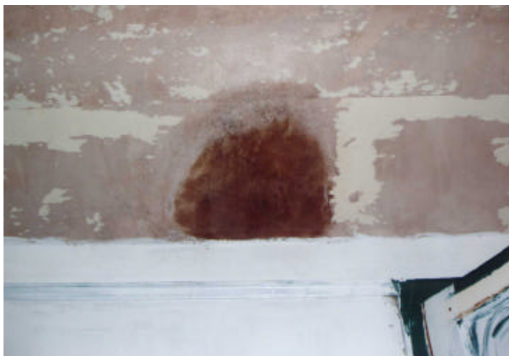
Moisissure suite à l'infiltration d'eau au plafond de la chambre des enfants
