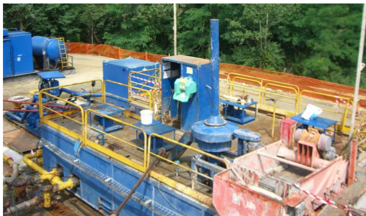
Figure 9 : Photographie des bassins à boue sur un rig à terre (Rig SMP 5, Lussagnet, France)
