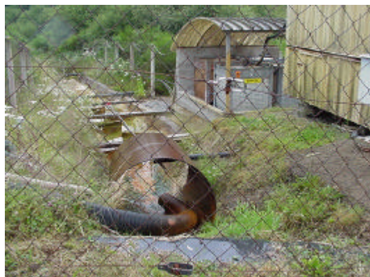
Figure 2 : Station de traitement des rejets d'Augères, Haute-Vienne
