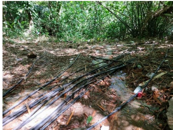
Réseau d'approvisionnement en eau :
