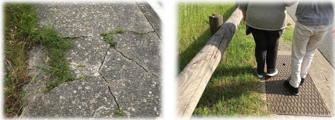
Exemple de trottoir cumulant plusieurs difficultés : largeur étroite, revêtement instable, et plaque métallique glissante
