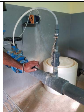
Figure 13. Point d'introduction du chlore pour la désinfection
