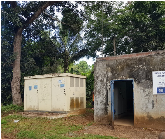
Figure 7. Station de pompage et transformateur EDM (vue Route Nationale)
