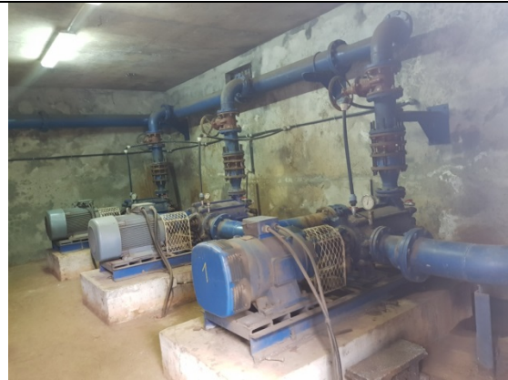
Figure 6. 3 pompes de la station de pompage et (seules 2 sur 3 fonctionnent en simultanément)
