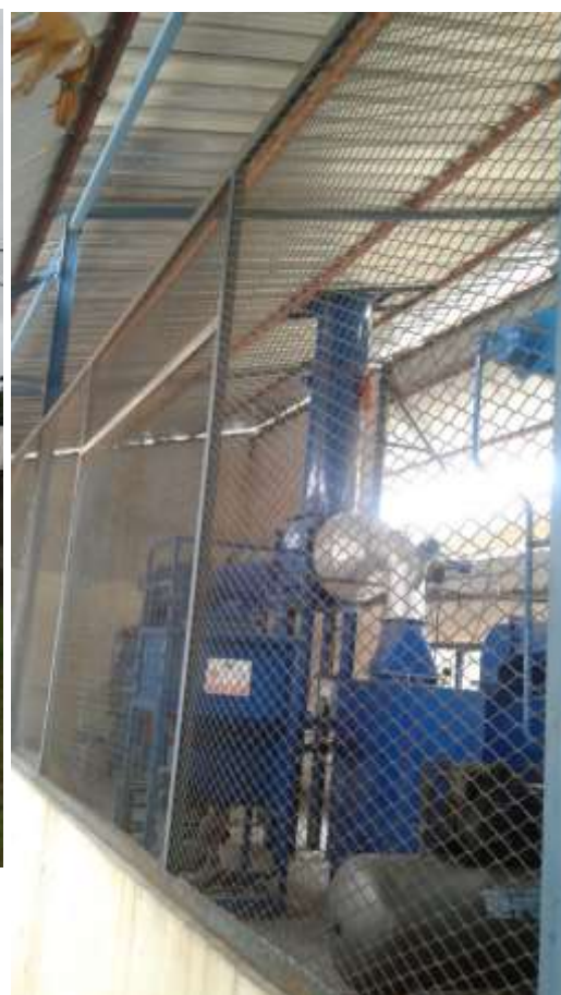
incinérateur à combustion
