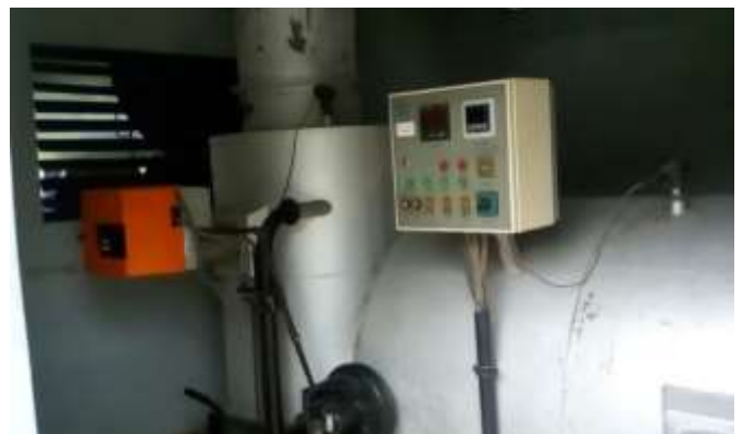
incinérateur moderne et fonctionnel
